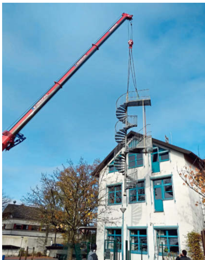
Da fliegt sie davon: Ein Kran hat die Feuertreppe am Hauptgebäude der Grundschule Asemissen angehoben. Die Treppe muss erst einmal weichen, weil die Fassade gedämmt wird.
